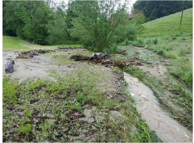
Verklausung von einem Rohreinlauf
