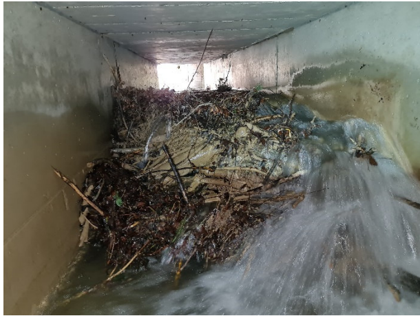
Verklausung in einem Kanal
